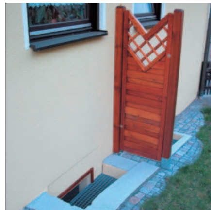
Příklad vzduchotechnického oddělení
