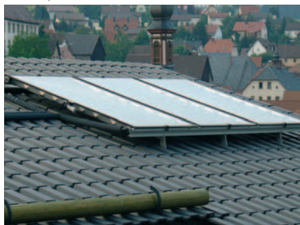
Kolektory na střeše, centrála v domě.
